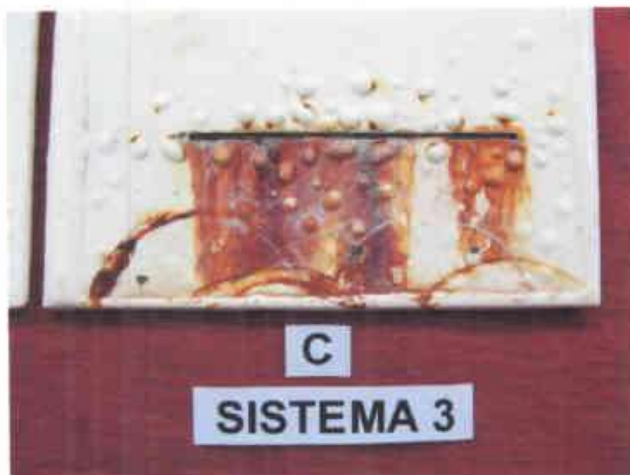
Fotografía 22 - SISTEMA 3, vista en detalle de la incisión en la probeta C, luego de 2016 horas de ensayo en cámara de niebla salina.
